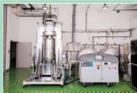
超高壓水設備
