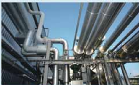
管路供應方案 Pipeline Distribution
