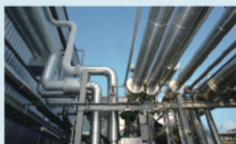
管路供應方案 Pipeline Distribution
