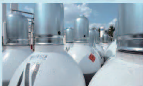
瓶裝氣體供應方案 Cylinder Distribution
