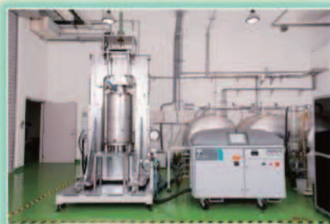
超高壓水設備
