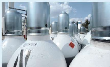
瓶裝氣體供應方案 Cylinder Distribution
