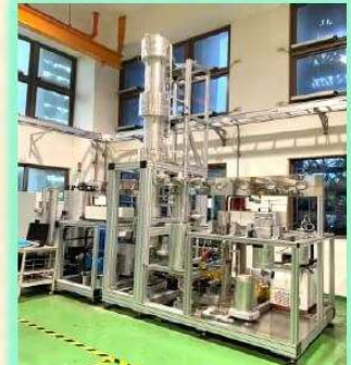
超臨界CO 2 分餾設備
