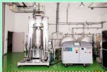
超高壓水設備
