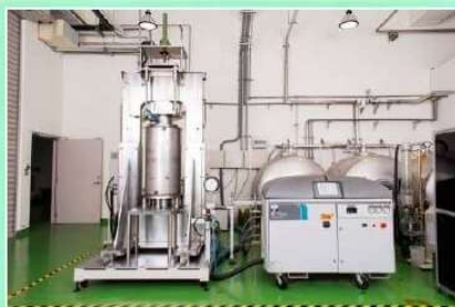
超高壓水設備
